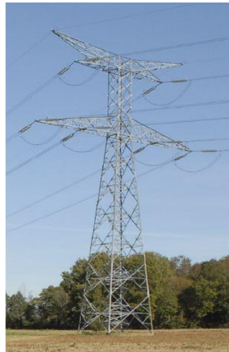
Pylône F44 d'angle
