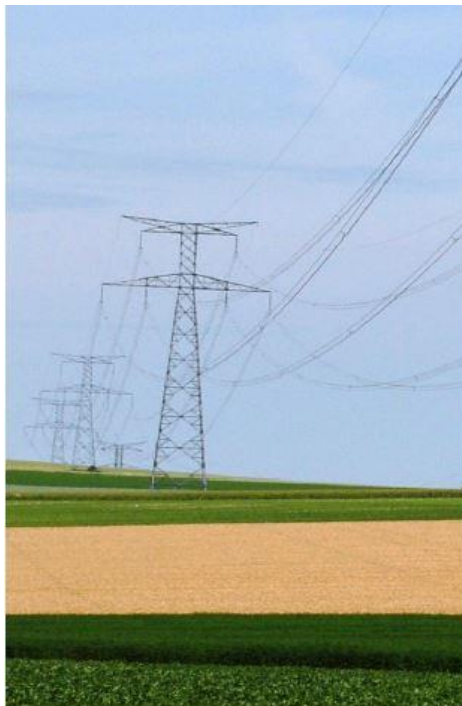
Pylône F44 de suspension
